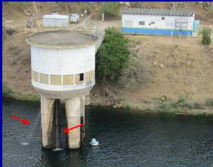
Captação em Pão de Açúcar/AL. Observa-se a existência de vazamentos
